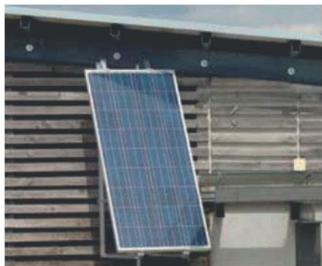
Impianti fotovoltaici per le case (magnitudo 4-5kWh)
